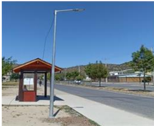
Fotografía 24. Instalación 3 postes con luminarias led, en Avenida Tres Poniente
