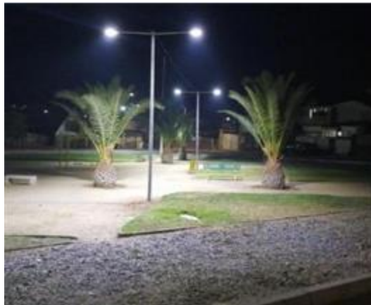
Fotografía 26. Instalación de 05 postes de gancho doble con 10 luminarias led, en centro y costados de plaza Francisco Werchez
