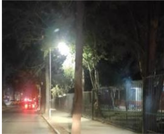
Fotografía 25. Instalación de 02 postes con luminarias led, en calle Ortuzar frente a Hospital.
